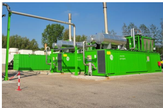
Moteurs à gaz pauvres
