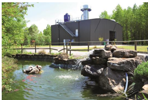
Evapo-concentrator pour le traitement de l'eau
